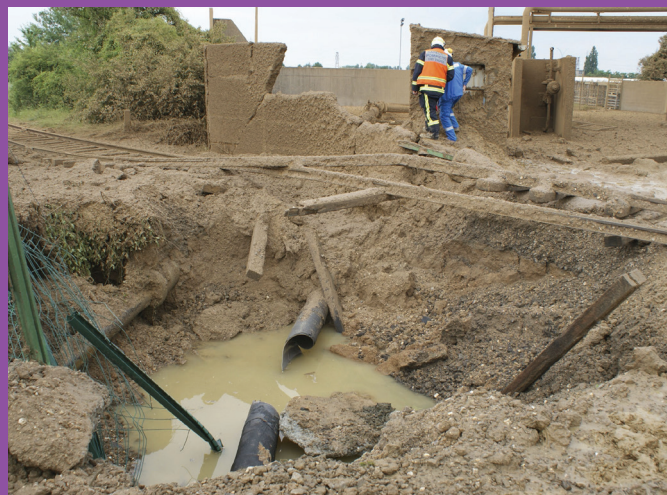
Canalisations de transport et distribution de gaz nature
